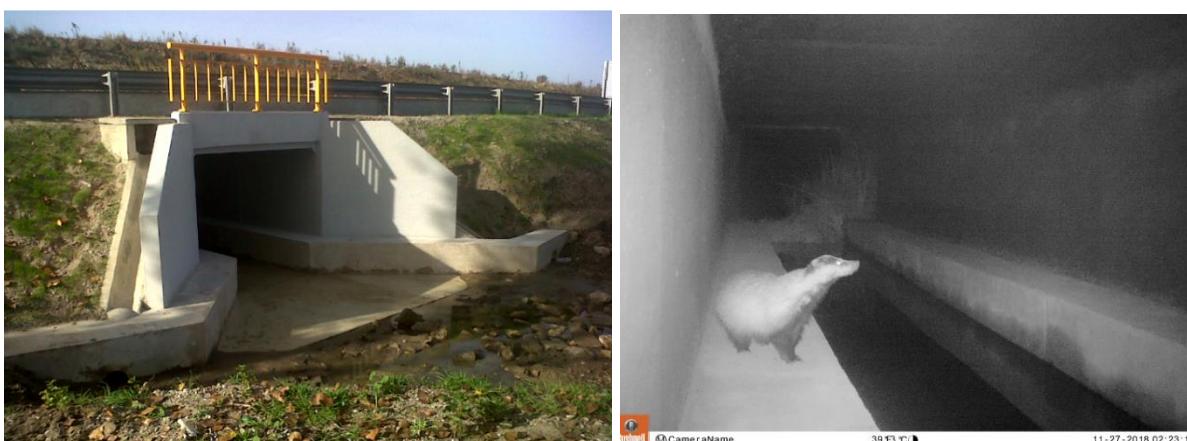
Fig. 29 – PH na EN18, ao km 274,800, com dois passadiços secos. Na fotografia da direita é possível visualizar um texugo a utilizar um dos passadiços (fotografia captada pela Universidade de Évora que se encontra a monitorizar a PH).
